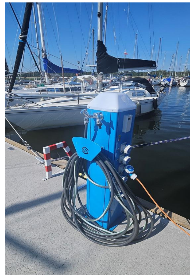
Postumenty na wodę i prąd wraz z oświetleniem i podlicznikiem
